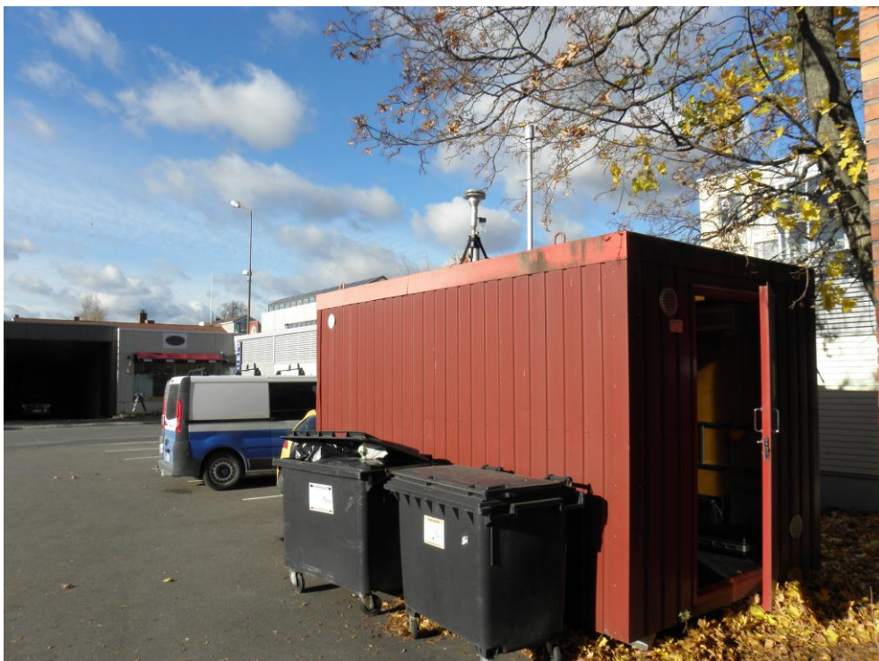
Kuva 9. Heinolan Keskustan Torikadun ilmanlaadun mittausasema.
